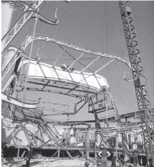
Le operazioni di demolizione (J. Delhaye, La Maison du Peuple de Victor Horta , Atelier Vokaer, Bruxelles 1987)
