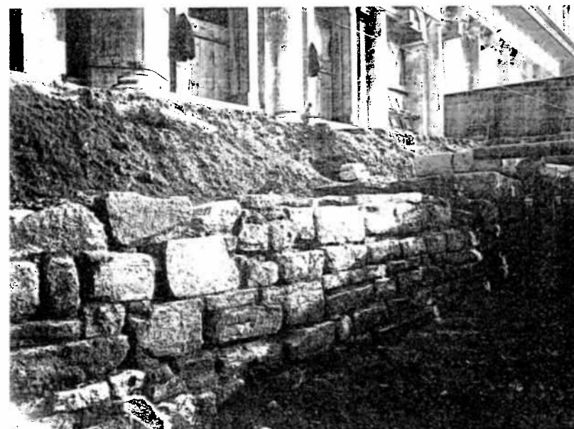
La fondazione parallela alla Libreria marciana e al campanile. È visibile l'angolo della fondazione dell'Ospizio Orseolo. Foto dell'ufficio tecnico comunale prodotta tra il 1905 ed il 1906.
