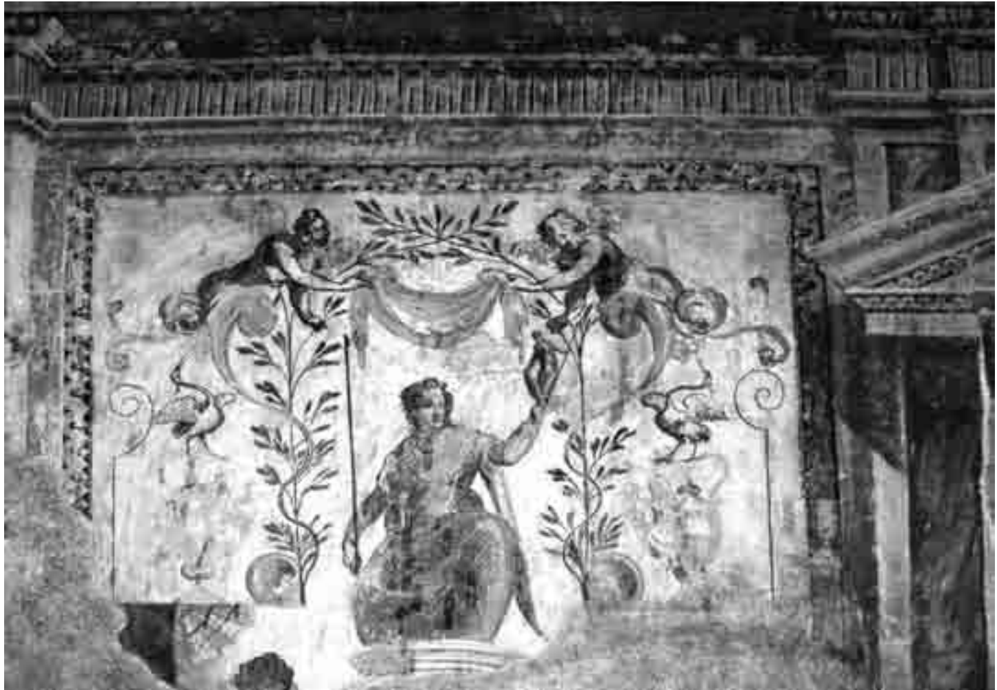
Frammenti di affresco in una sala al pianterreno di villa Della Torre a Mezzane. Nella stanza si nota una sovrapposizione di strati di intonaco con pitture che possono darsi dagli inizi alla fine del XVI secolo, con rilevanti tracce di decorazioni messe in atto prima dell'intervento della bottega di Farinati.
