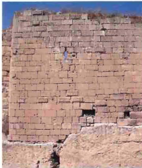
Res. 6: 4. Makro-dönemde doğu payanda duvarının bir parçasının yeniden inşası, güneydoğudan (fotoğraf C. Tonghini).
