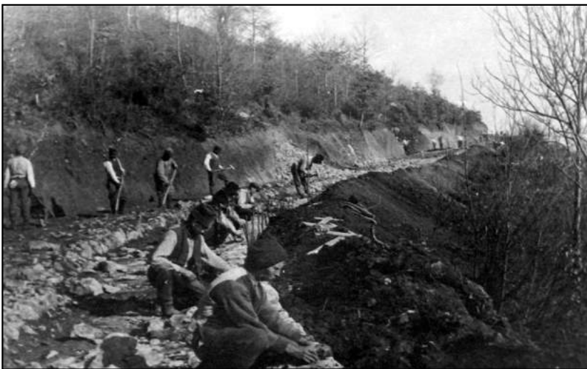
FIG. 4. Ragazzi e operai durante la costruzione di una strada, località Pradipaldo. Fonte: Museo della guerra di Canove-Roana.
